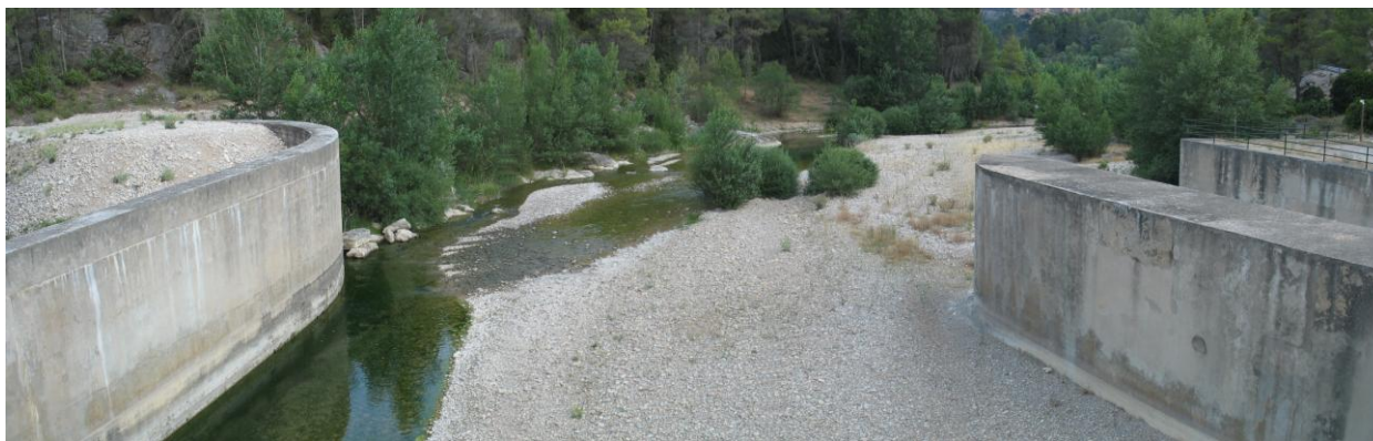
Figura 44-31. Estación de aforos del río Bergantes.
