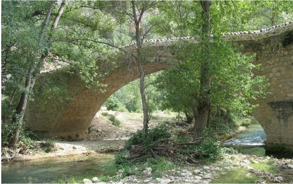
Figura 44-8. Restos de crecida en la zona inicial del trazado.
