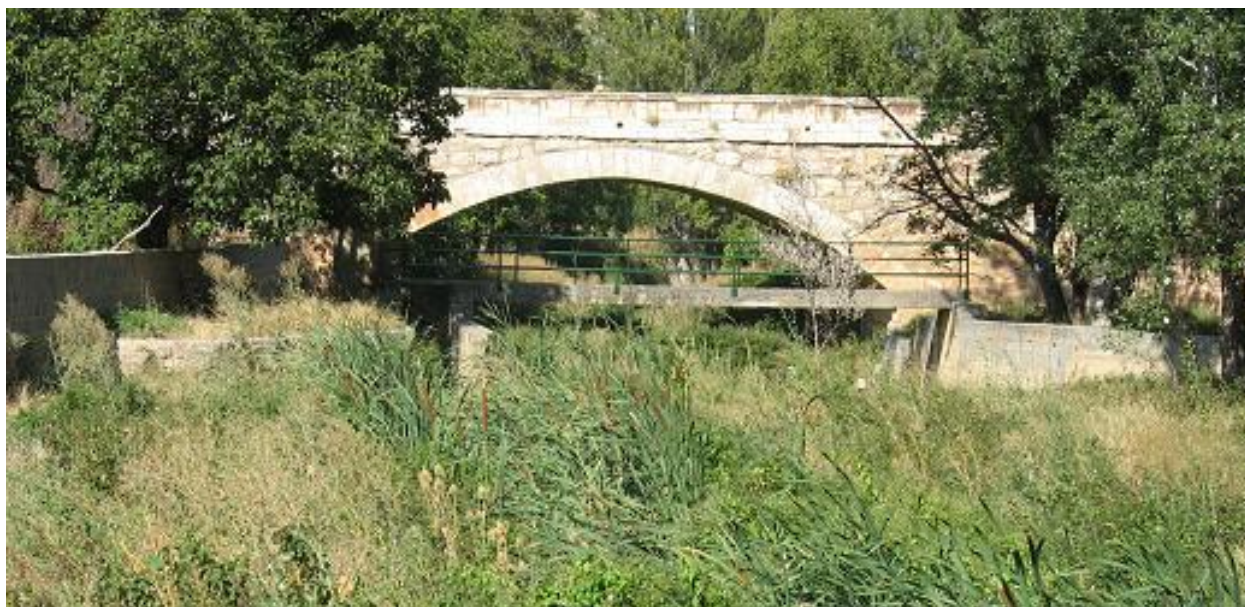
Figura 38-4. Río Aguas Vivas con el cauce colonizado por vegetación en la localidad de Blesa.
