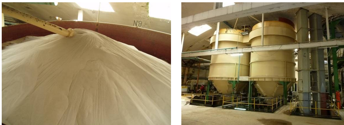
Ilustración 29: Fotos de detalle de la planta de tratamiento
